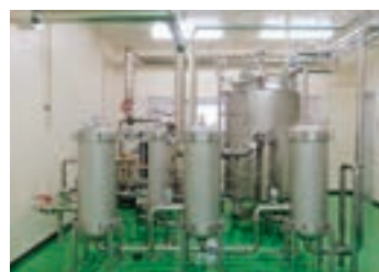
(フィルター濾過装置)
