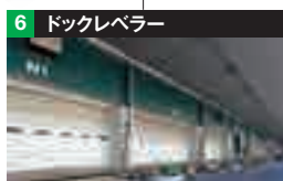
様々な仕様のトラックに対応できるドックレベラー
